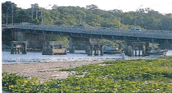
Figura 16 - Pilares da Antiga Ponte
