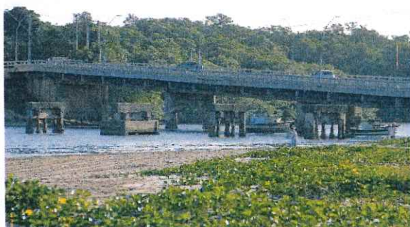
Figura 16 - Pilares da Antiga Ponte
