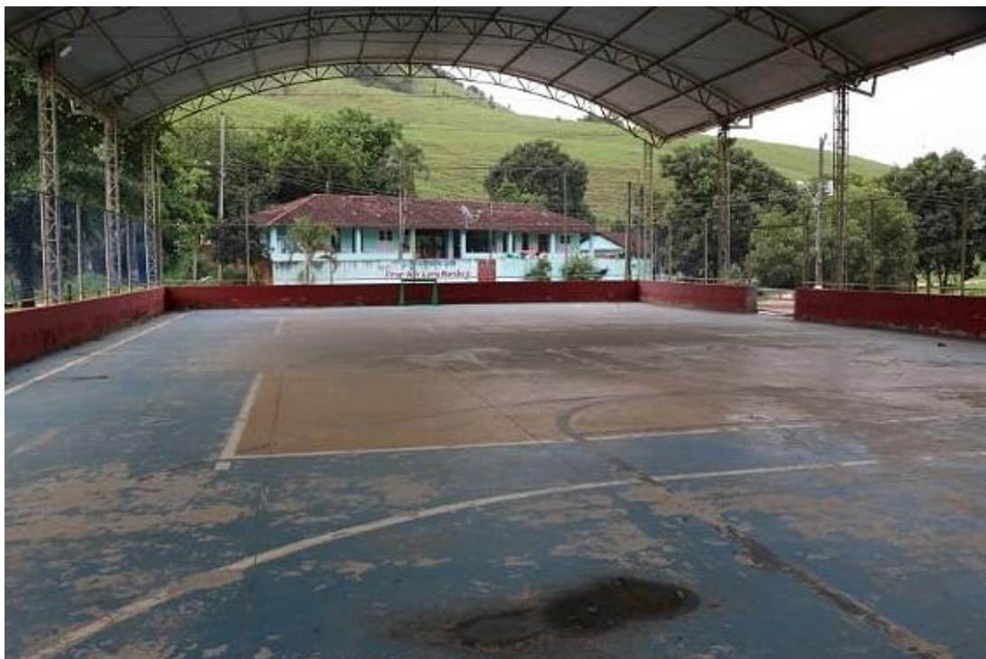
Necessidade de melhoria nas quadras das comunidades, a exemplo de pinturas das paredes, pisos e das demarcações no piso
