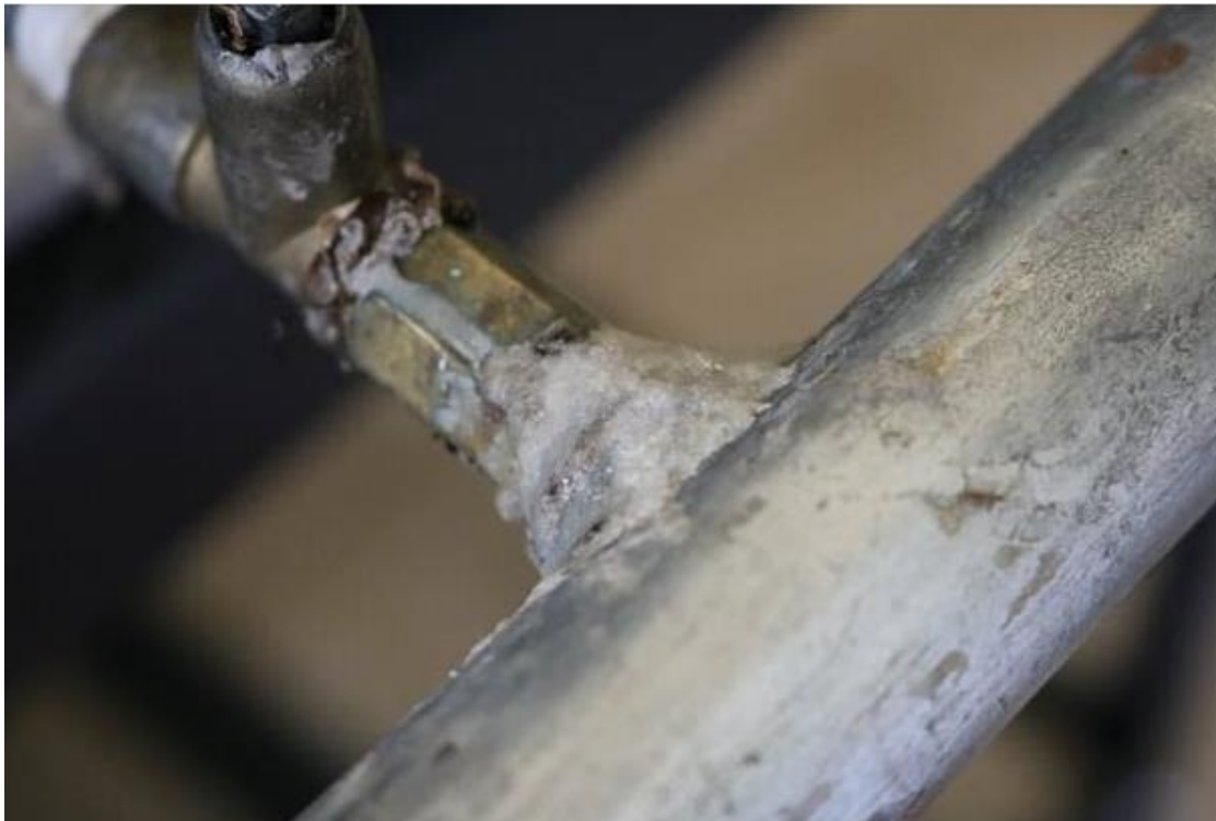
Registro do gás de cozinha que apresentava vazamento e foi colocado cola adesiva para minimizar o problema.
