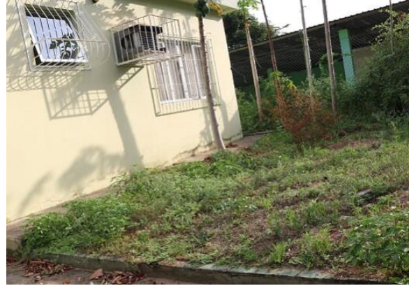
Necessidade de limpeza e capina na unidade de saúde
