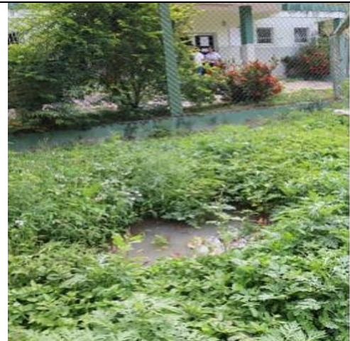
Fossa que fica em frente aos equipamentos públicos transbordando e com muito mato
