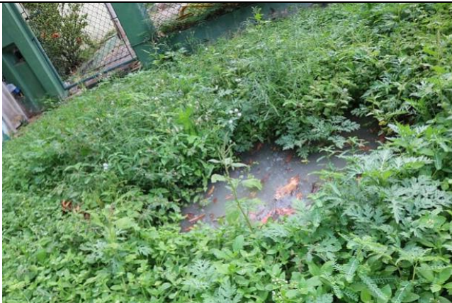
Fossa que atende a escola e unidade de saúde transbordando
